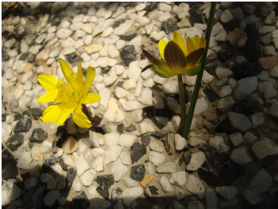
DVA LJUTIĆA KOJA SU SE LJUTITO PROBILA KROZ PUKOTINU U ZIDU
